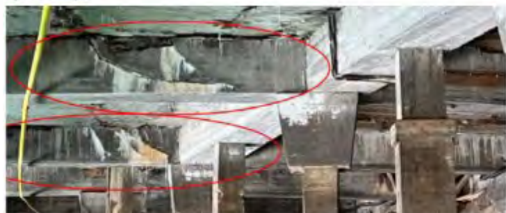
Figur 6 Store sprækker med rust og saltnetslag i bylker. Foto: Multiconsult
