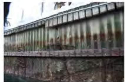
Figur 2-12: Storet østret i betongveggen.
